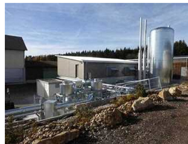
バイオガス発電施設
